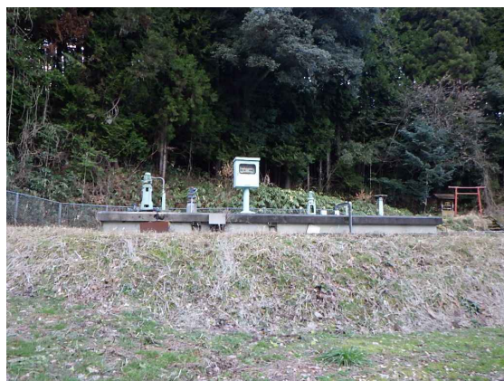
宇留地浄水場 フロック形成池
