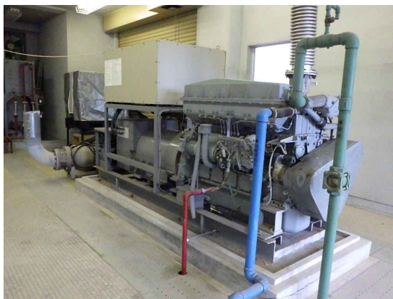
上野浄水場 自家発電設備
