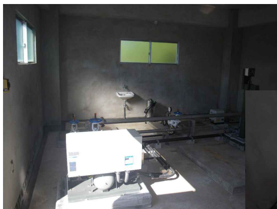
平成 24 年市ノ坂中継槽 インバータポンプを導入
