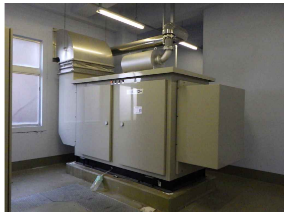
空港第 1 送水ポンプ場 自家発電設備
