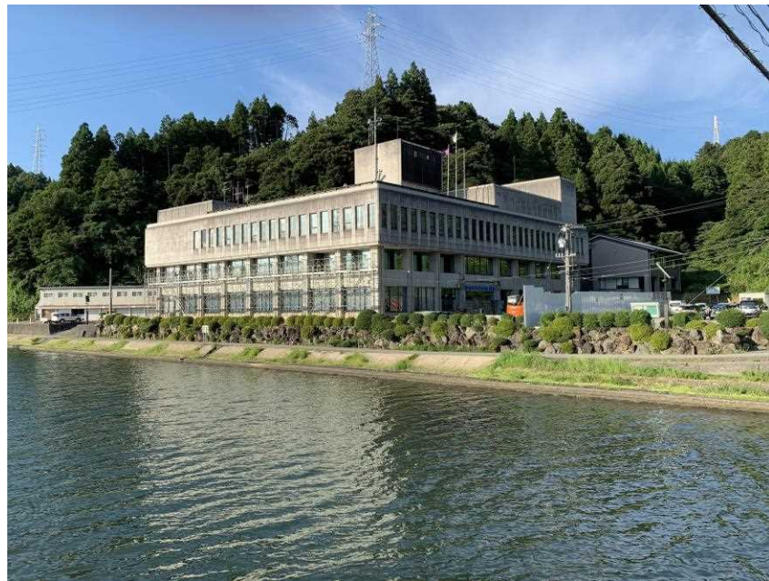
R2.8.21：川沿いのカイズカイクキが伐採され、足場が組まれています。
